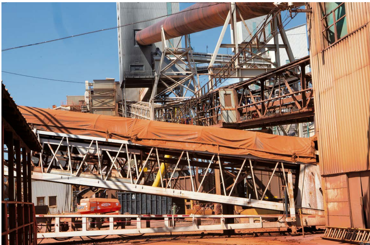
Pour pallier l'arrêt des activités du convoyeur de déchargement principal, un plan à court, moyen et long terme a dû être rapidement mis en place.
